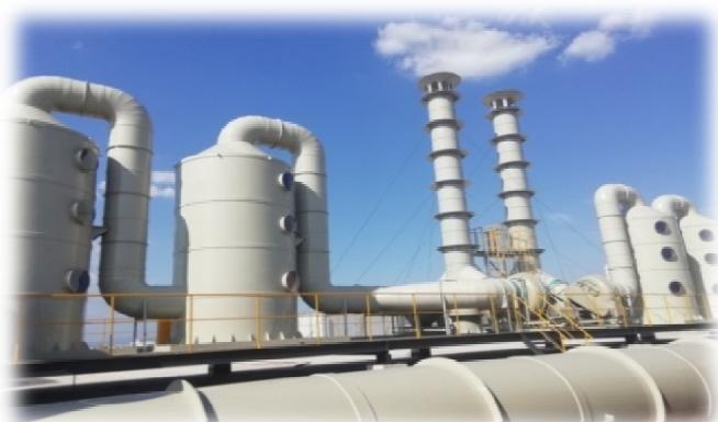
屋顶废气处理设施
